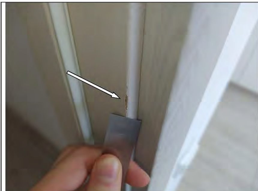
Фото №37. Коробка деревянного дверного блока в кухне имеет дефекты (скол).
