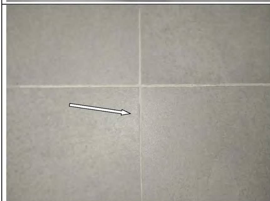
Фото №51. Затирка напольной плитки выполнена с нарушениями в ванной комнате: неполное заполнение шовного пространства затирочным составом.
