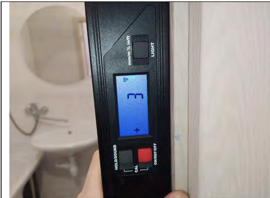
Фото №34. Отклонение коробки дверного блока в ванной комнате.
