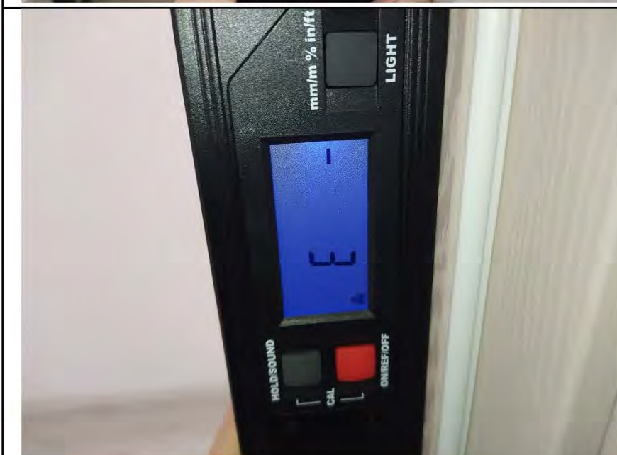
Фото №35. Отклонение коробки дверного блока в спальне.
