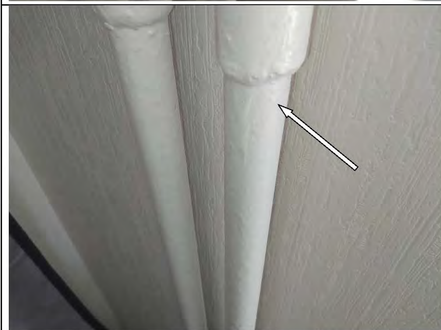
Фото №72. Окрашивание труб отопления выполнено с дефектами в спальне (подтеки).
