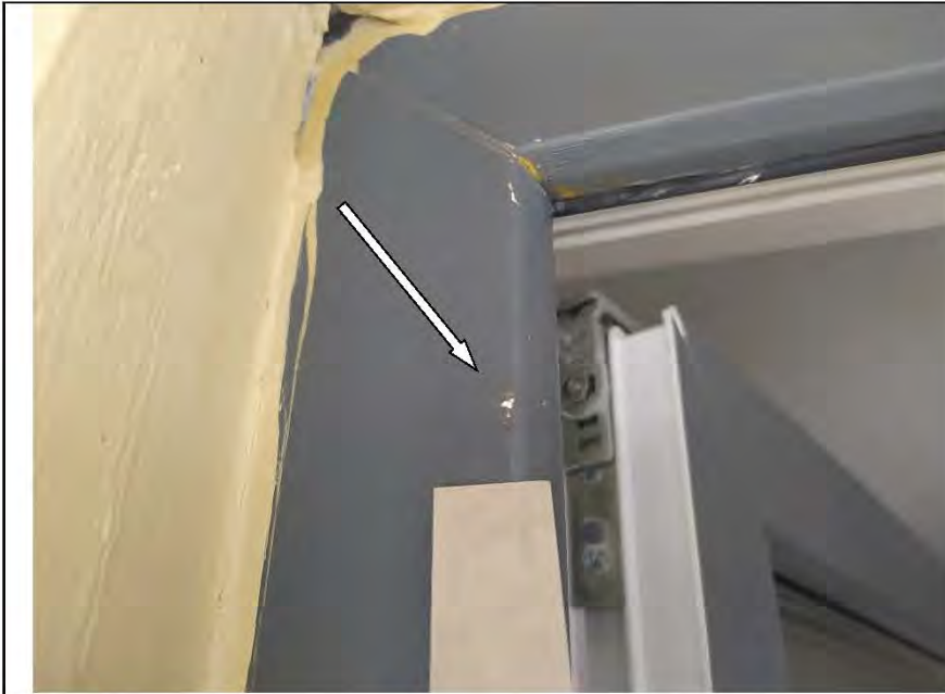
Фото №22. Профиль ПВХ оконно- дверного блока в спальне имеет дефекты (скол).
