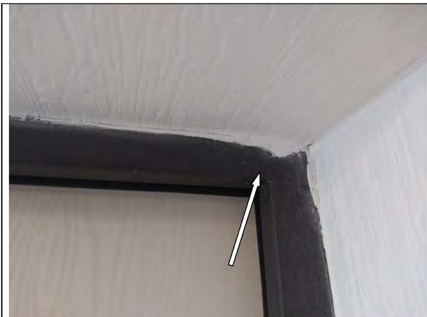
Фото №67. Коробка входной металлической двери имеет дефекты (загрязнение малярными составами).
