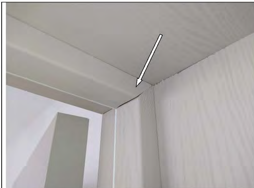
Фото №40. Элементы дверного блока соединены не надежно в спальне.
