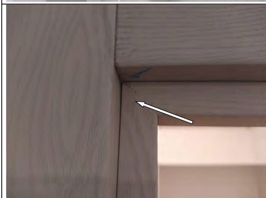
Фото №41. Элементы дверного блока соединены не надежно в гардеробной.
