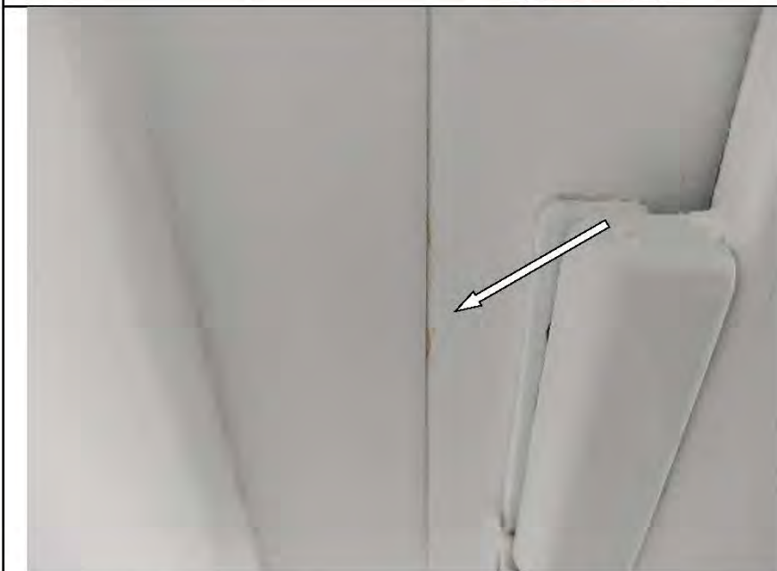
Фото №20. Профиль ПВХ оконного блока на кухне имеет дефекты (загрязнение строительными составами).
