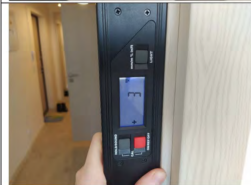
Фото №33. Отклонение коробки дверного блока в кухне.
