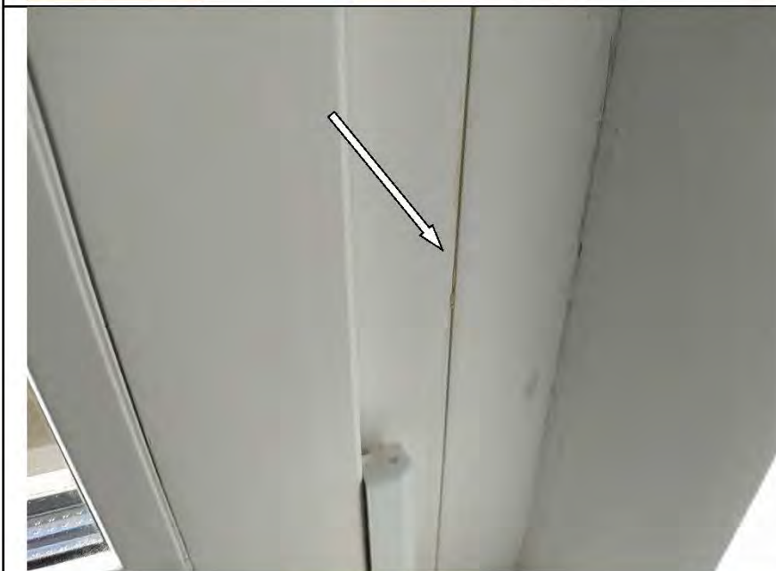
Фото №23. Профиль ПВХ оконно- дверного блока в спальне имеет дефекты (загрязнение строительными составами).
