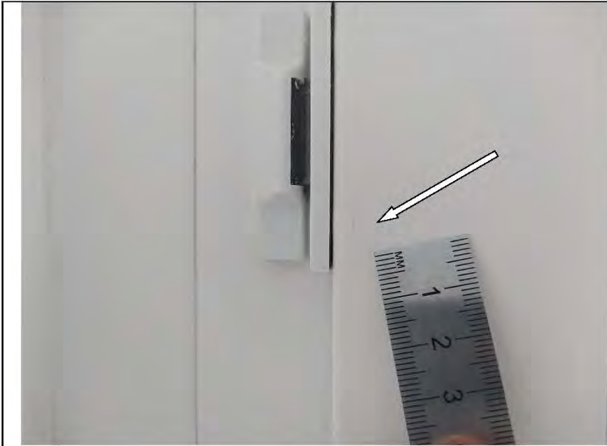
Фото №19. Профиль ПВХ оконного блока на кухне имеет дефекты (царапины).
