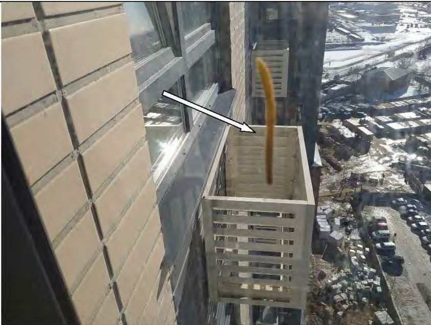
Фото №26. На стеклопакете оконного блока на балконе имеется дефект (загрязнение строительными составами).
