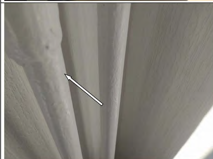
Фото №71. Окрашивание труб отопления выполнено с дефектами в кухне (подтеки).
