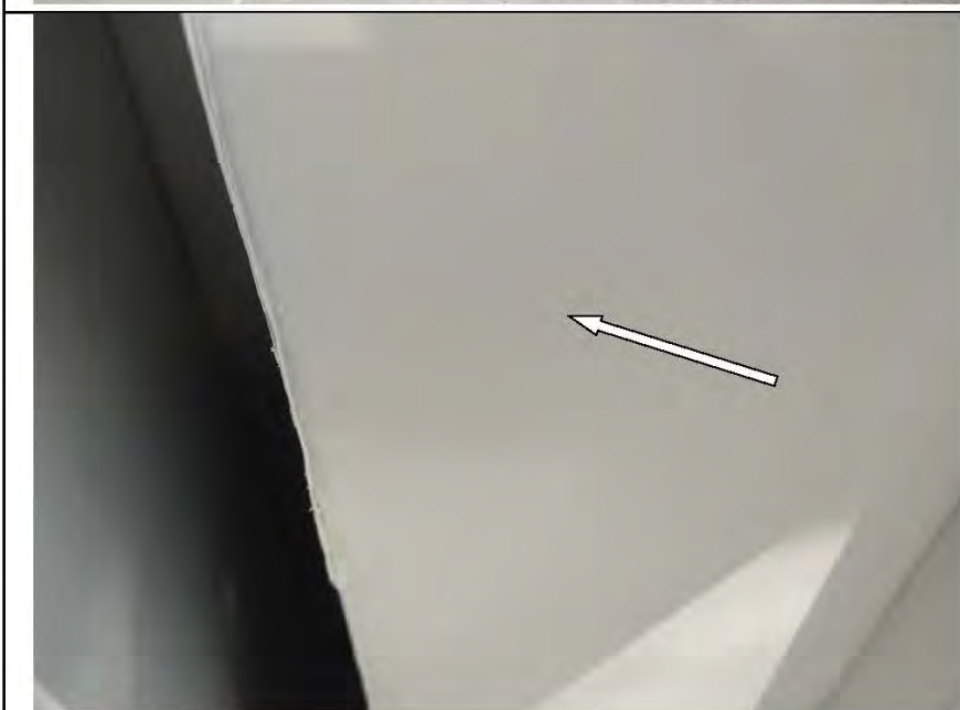
Фото №17. Окрашенные откосы оконного блока в кухне выполнены с дефектами (брызги).
