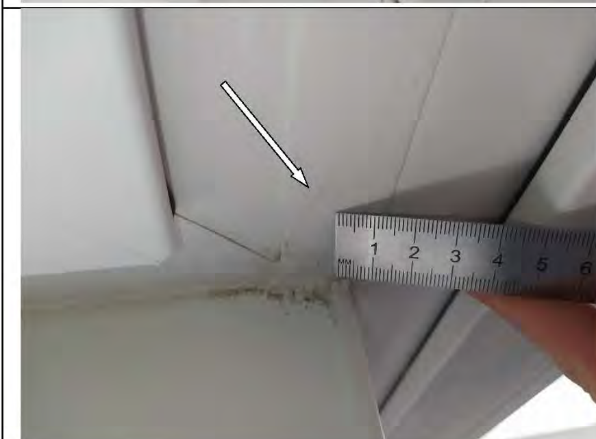
Фото №21. Профиль ПВХ оконно-дверного блока в спальне имеет дефекты (царапина).
