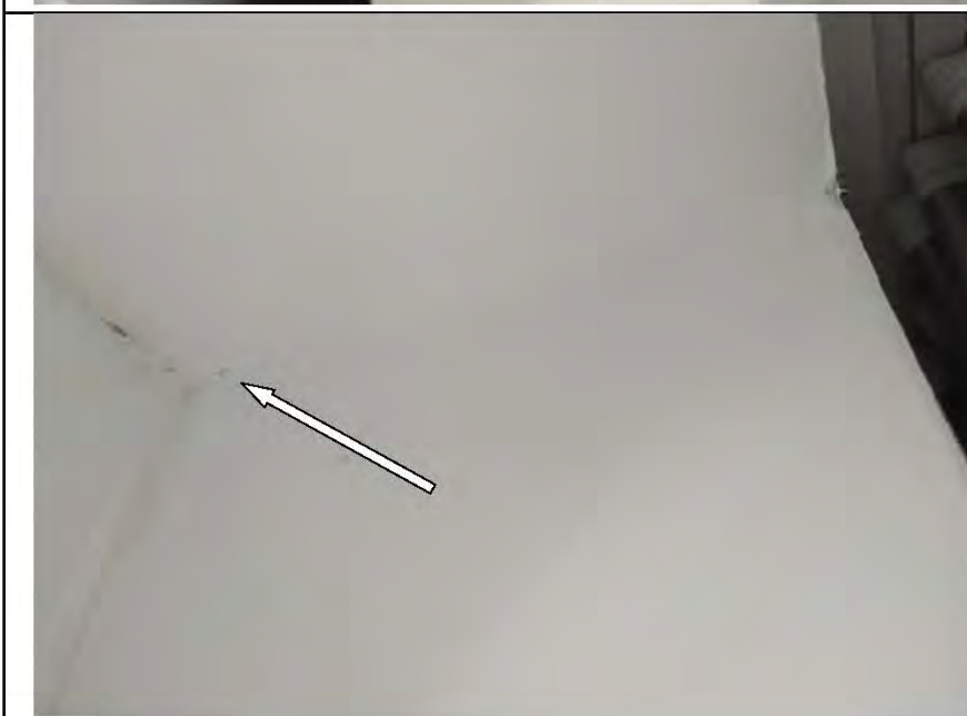
Фото №18. Окрашенные откосы оконно-дверного блока в спальне выполнены с дефектами (отлупы).
