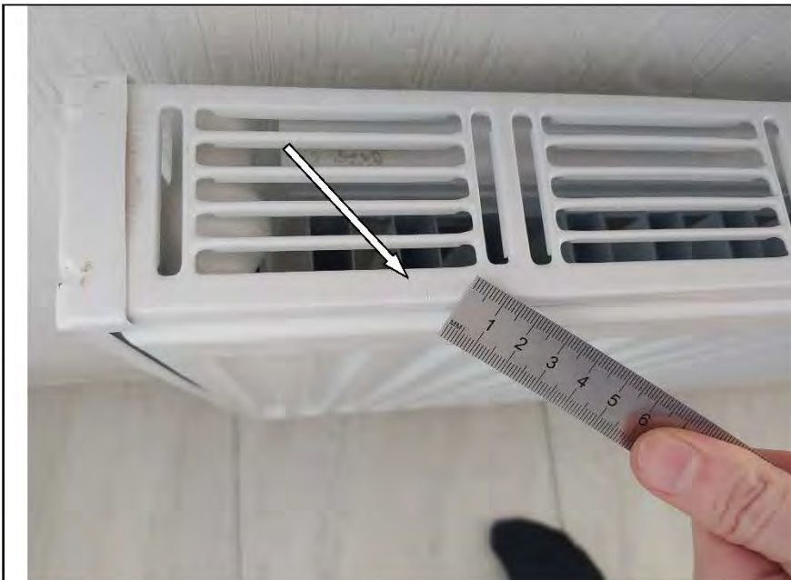
Фото №31. Отопительный прибор имеет дефект покраски защитного кожуха в кухне (царапина)
