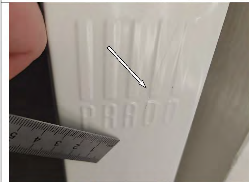
Фото №32. Отопительный прибор имеет дефект покраски защитного кожуха в спальне (царапина)
