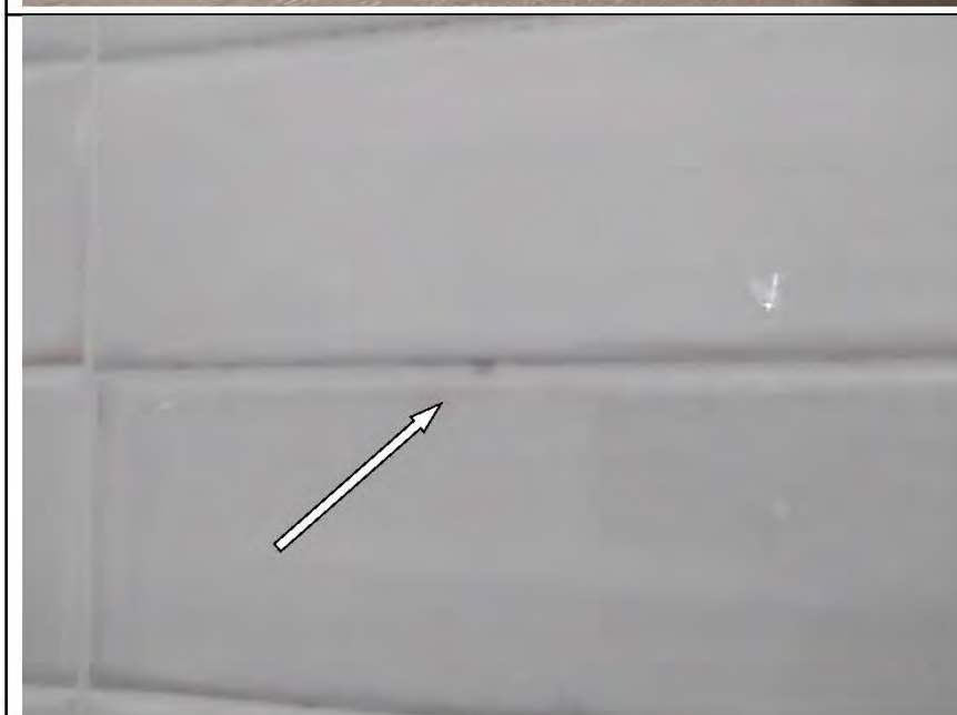
Фото №50. Затирка настенной плитки в ванной комнате выполнена с нарушениями (каверны).
