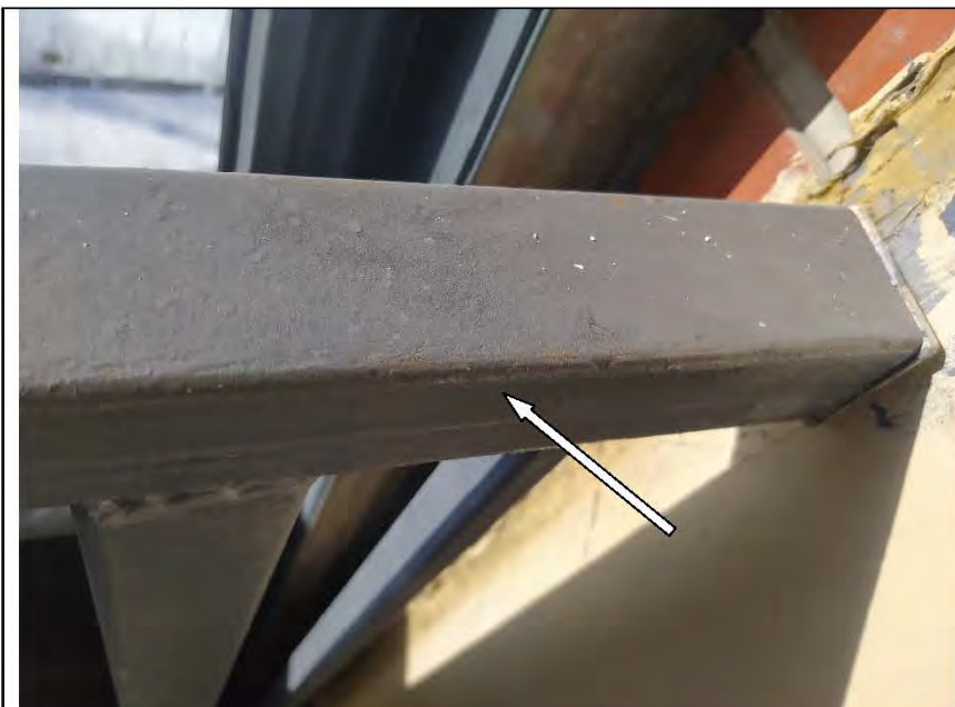
Фото №70. Дефект металлического профиля ограждения лоджии (коррозия)
