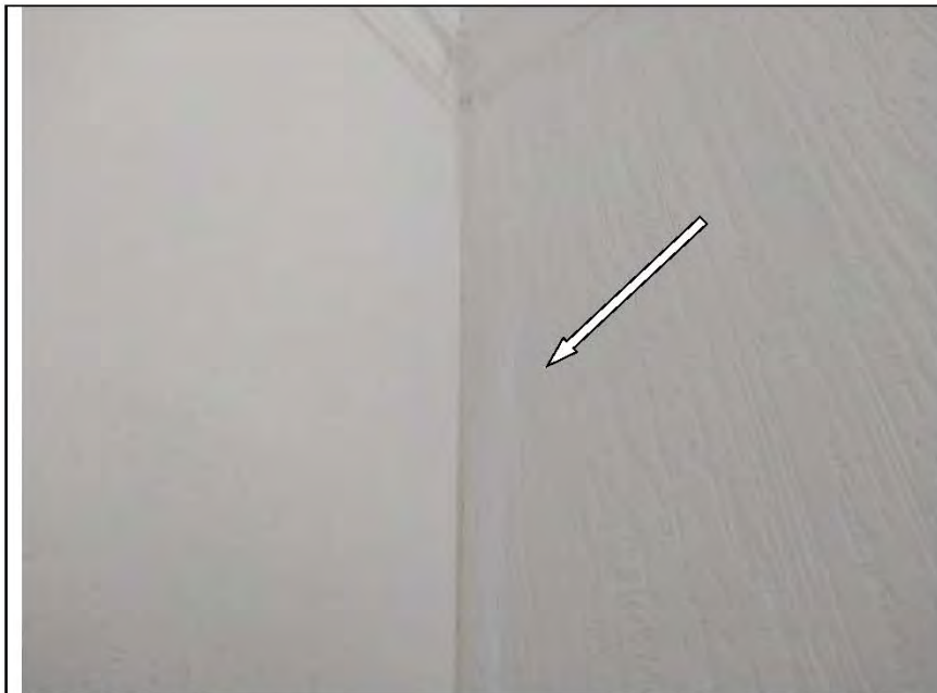
Фото №46. Воздушные пузыри обоев в кухне.
